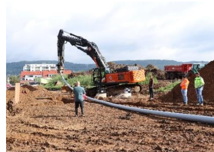
Bauausführung Low-Ex Netz mit polymerem Rohrsystem | Quelle: HEWA GmbH, Hersbruck // Scharnagl Hoch- und Tiefbau GmbH, Weiden/Oberpfalz
