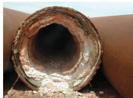
Abb. 4: Scaling in einem Produktionsrohr
